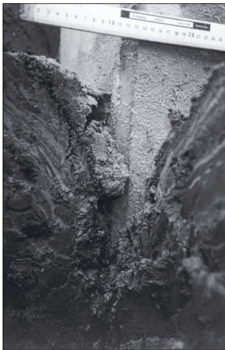
Bild 5: Freigelegter Verschleppungstrichter bei einem Betonrammpfahl
