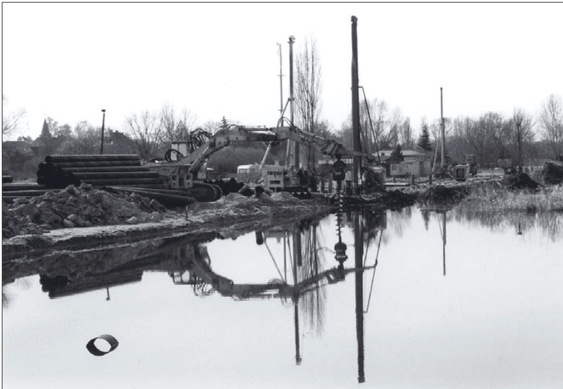
Bild 8: Überflutetes Gelände im Trassenbereich
